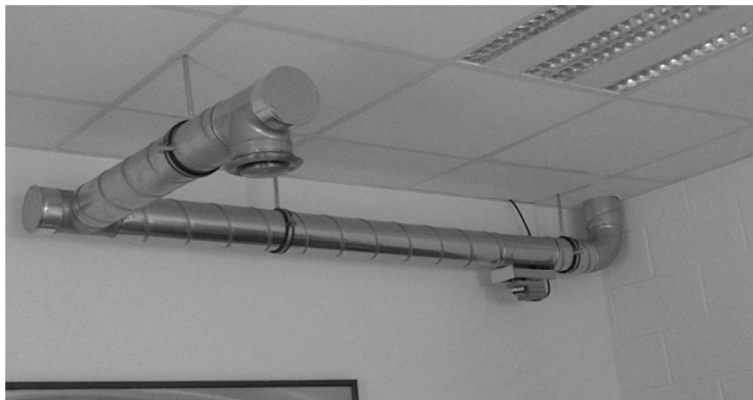
Figura 4. Sistema de control por multi zona.
