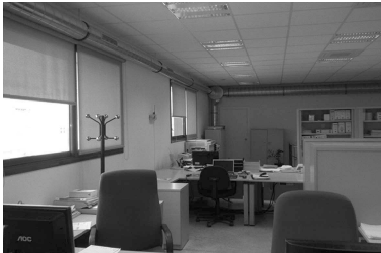
Figura 3. Red de ventilación en oficinas.
