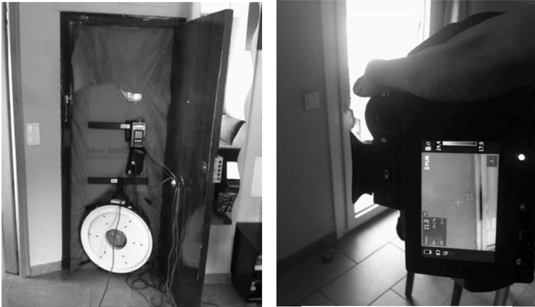
Figuras 2. Durante un test de estanqueidad y la localización de las infiltraciones de aire.
