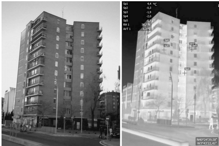
Figura 3. El estado actual del edificio Avda. Manzanares 2 en Madrid Río.
