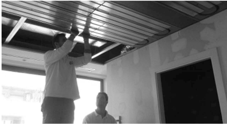
Figura 1a. Detalle de montaje de TECS: Montaje de sistema térmico, formado por perfiles de aluminio en forma de aleta donde se inserta el circuito de tubería para climatización.
