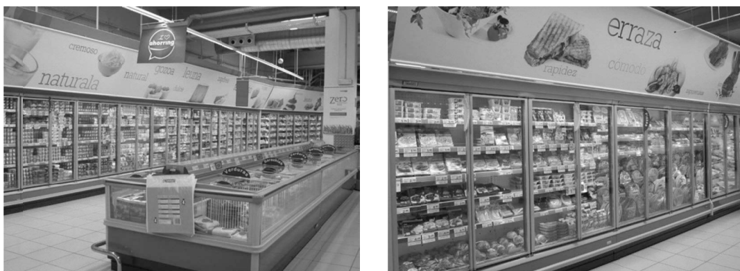
Figura 4. Refrigeración de alimentos en Eroski.
