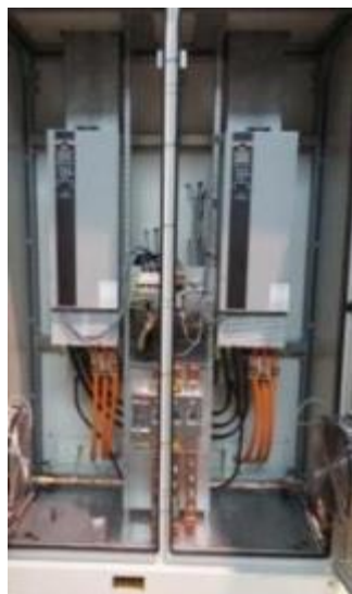
Variadores del compresor + conexión de alimentación principal
