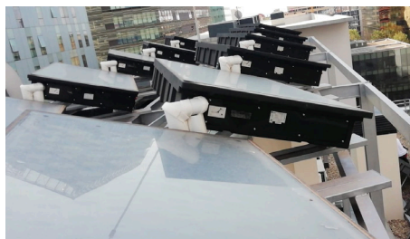
BARCELONA Multivivienda (23 viviendas) 19 OKSOLes instalados
