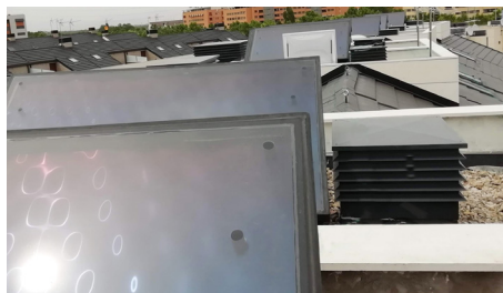
LEGANÉS (Madrid) 13 viviendas adosadas 13 OKSOLes instalados
