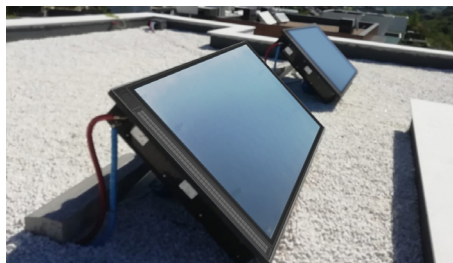
MIRAMÓN (San Sebastián) 2 viviendas adosadas 2 OKSOLes instalados
