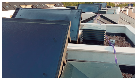
SAN SEBASTIÁN DE LOS REYES (Madrid) 14 viviendas adosadas 14 OKSOLes instalados
