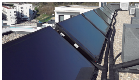
SOTO DE LEZKAIRU (Pamplona) Multivivienda (41 viviendas) 11 OKSOLes instalados
