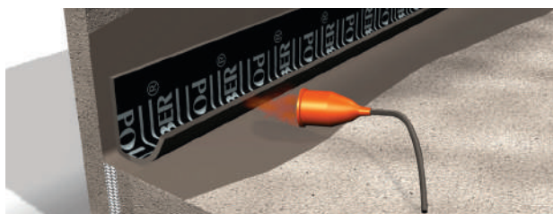
Aplicar banda de refuerzo.
