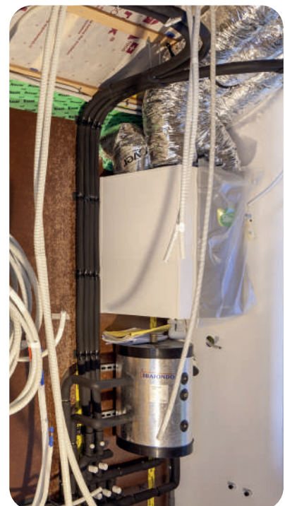
Sistema de Ventilación de la vivienda
