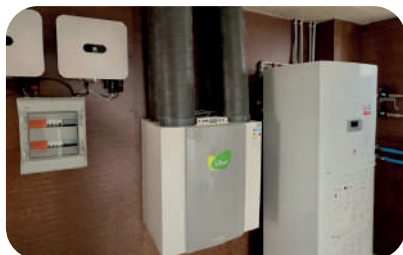
Sistema de Ventilación de la vivienda
